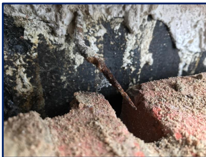
Afbeelding: Spouwankers heeft geen verbindingen meer met het gemetselde buitenblad.
