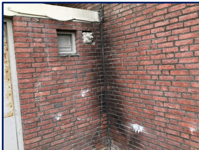
Afbeelding: Door uiteenlopende oorzaken aangetast metselwerk.
