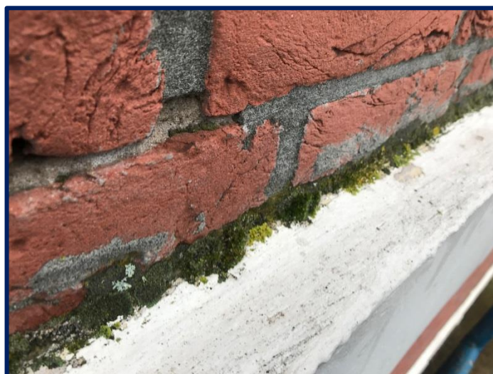
Afbeelding: De betonnen metselwerkondervanging wordt eveneens door mos- en algengroei aangetast.
