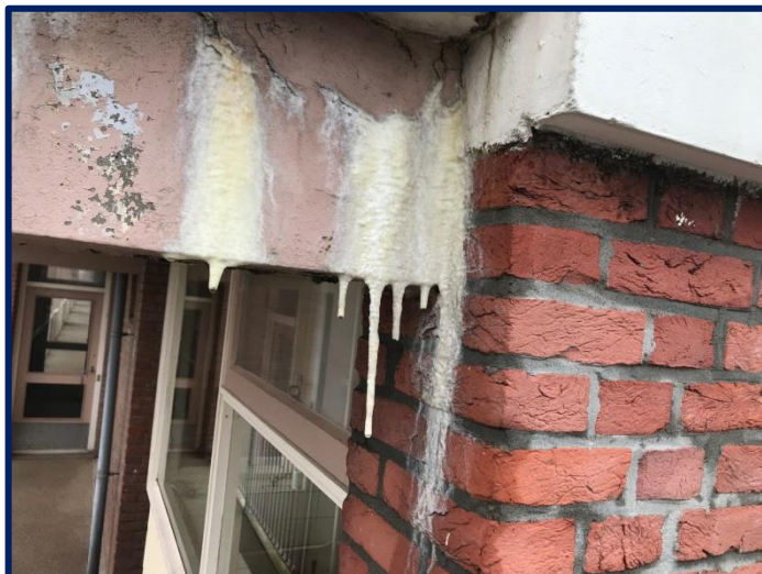
Afbeelding: Het metselwerk is plaatselijk aangetast door uitbloei van kalk en sulfaten uit het belendende beton.
