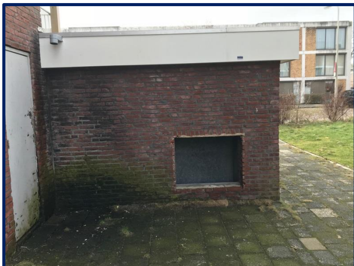
Afbeelding: Verweerd metselwerk t.g.v. ontbrekende HWA.
