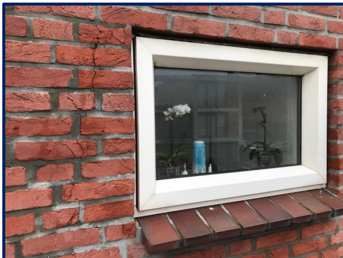
Afbeelding: Vervormd metselwerk t.g.v. aanwezige oude kozijnankers.
