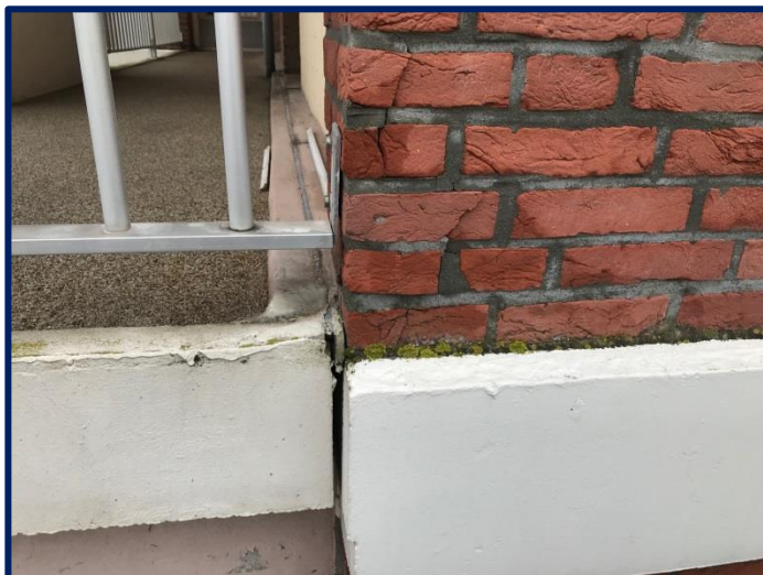
Afbeelding: Vervormd metselwerk als gevolg van bevestiging hekwerk.
