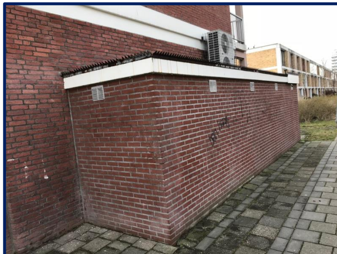
Afbeelding: Het metselwerk is plaatselijk ontsiert door graffiti.
