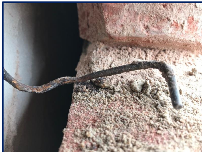
Afbeelding: Spouwanker in grove mate door corrosie aangetast.
